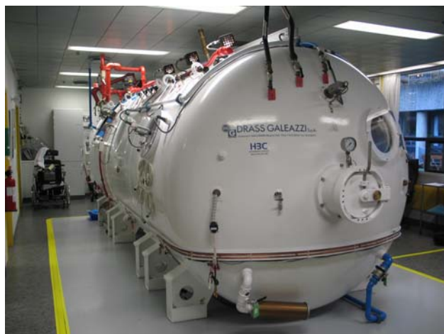
Ståltanken med Rigshospitalets trykkammer.
